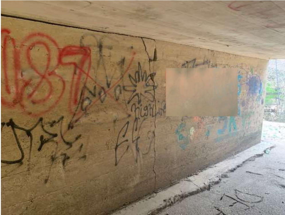
Photo 1: Large crack in middle of intermediate bridge support indicating movement Foto 1: Grieta grande en medio del soporte del puente intermedio que indica movimiento
