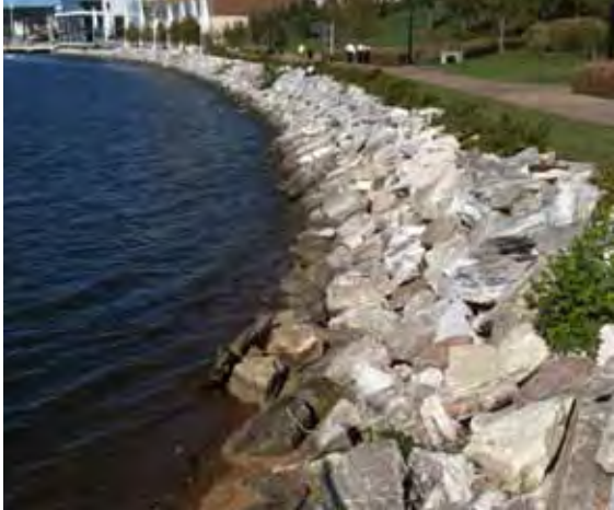
8.11.2.A5: Rip-rap wall
