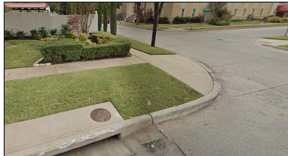
Non Compliant ADA Ramps
